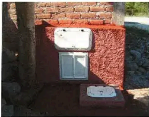
Trappes d'accès au réceptacle des toilettes, Mexique.
